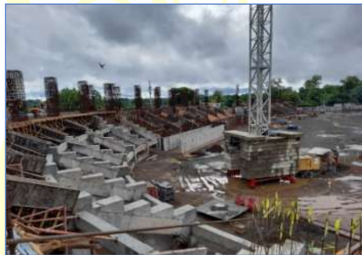
Vista panorámica del área de gradería central, donde se aprecia la construcción de vigas raker.
