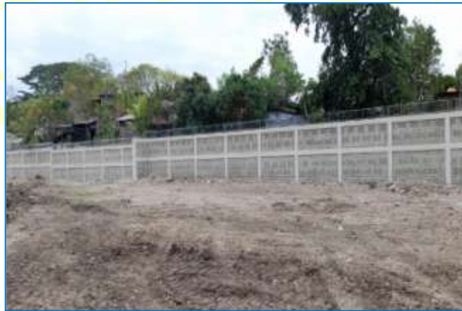
En la fotografía observar el muro perimetral de mampostería confinada, serpentina, ya finalizado
