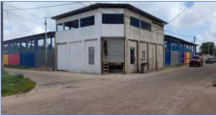
Vista panorámica del acceso principal del Estadio de Beisbol, donde se aprecia la instalación de verjas, cubierta de techo, cortina metálica enrollable.
